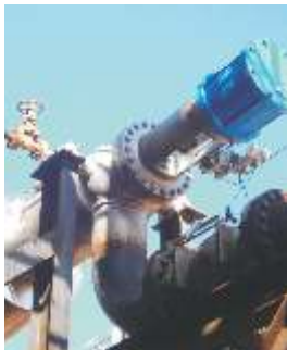
Válvula Bypass de Turbina USINA COLORADO
