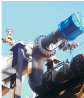
Válvula By-Pass de Turbina USINA COLORADO
