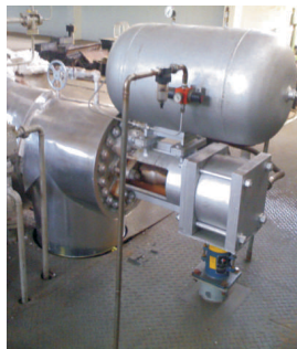
Válvula Globo com Atuador pneumático para proteção de turbina TGM - CITROSUCO
